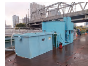
濁水処理プラント
