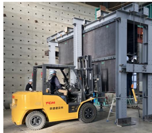
写真-9 解体状況
