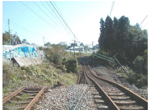
写真-3 崩壊状況(軌道部)
