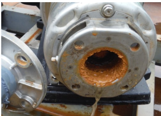
写真-1 鉄バクテリア付着状況(稼動 36 日後)
