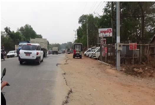
交通量が多く、路肩と車道に段差があるため、安全面でも改良が必要。
