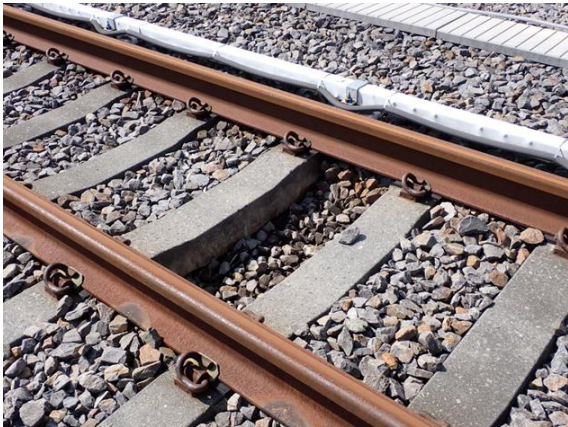
(b)陥没状態
