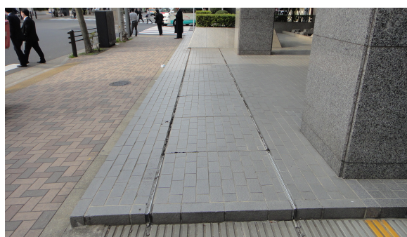
写真-2 本震後のエントランス部の免震蓋（EXP.Joint部）の状況
