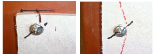
写真-14 フレキシブルボード①のねじ周りのひび割れ状況例
