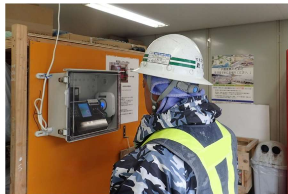
写真-6 出退勤用顔認証機の設置状況 (山岳トンネル)
