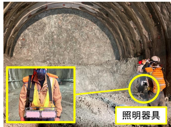
図-1 照明器具使用状況
