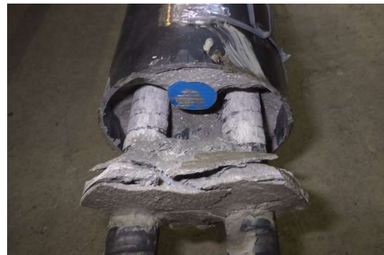
写真－4 鉄筋抜け出し状況
