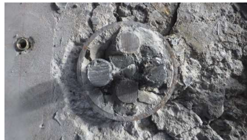
写真-5 継手端部の損傷状況
