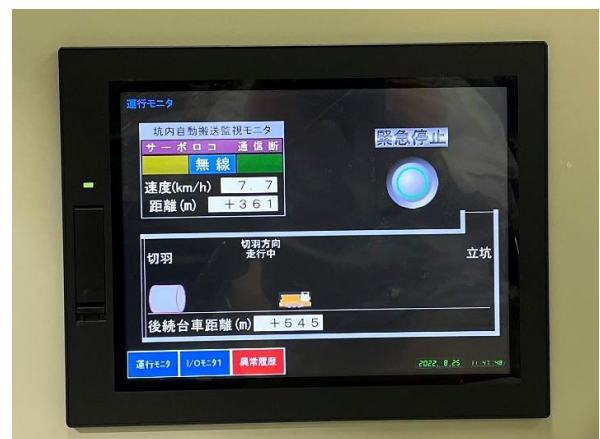
写真-1 中央制御室監視モニタ画面
