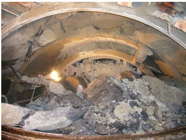
写真-1 崩落状況
