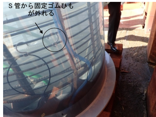
写真-8 固定ゴムひも外れ状況
