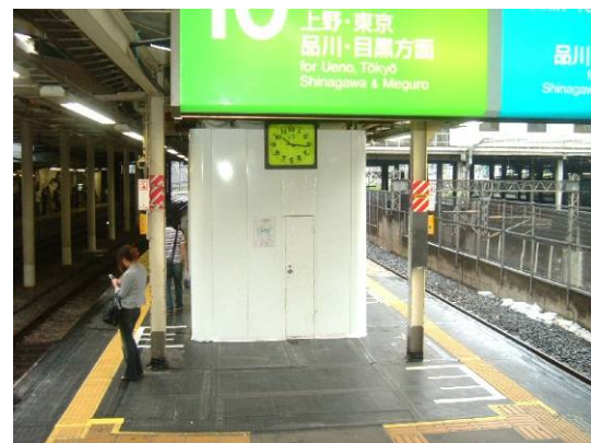
写真-1 ホーム上に設置された仮囲い
