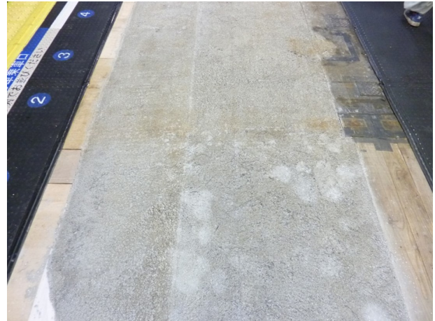
写真-18 3日後表面状態
