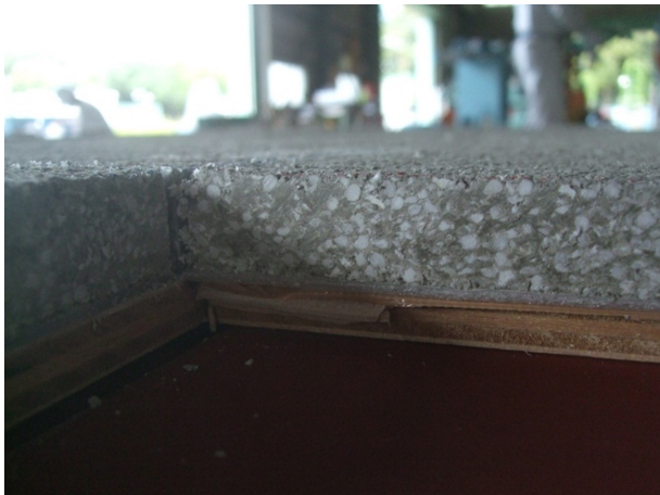
写真-11 切断面近景
