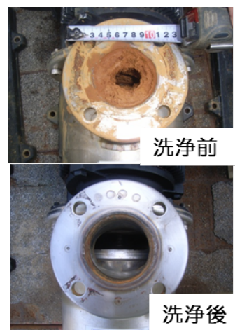
写真-1 スケール付着状況 (ポンプ内)
