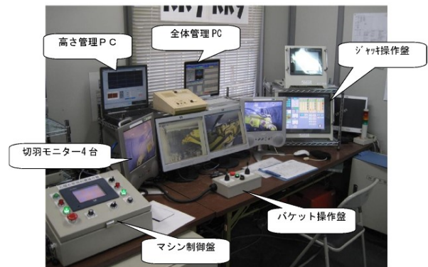
写真-3 中央管理室内状況
