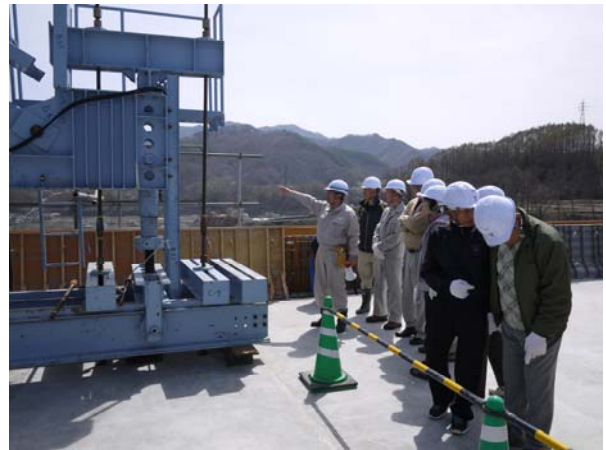
橋梁の上で工事の説明を行いました。皆さん興味深く聞き入ってくださいました。
