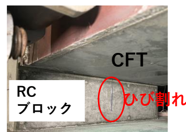
写真-6 試験終了後の接合面の状況(No.5)
